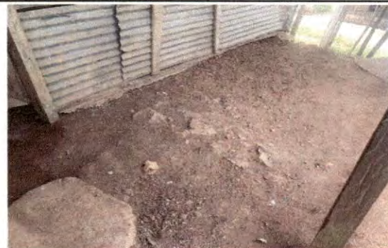
Foto 10: piso en mal estado-
