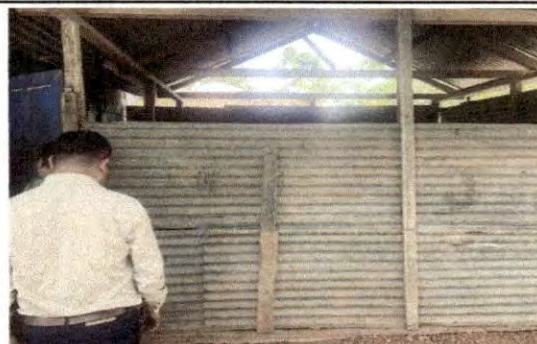
Foto 4: Pared de láminas en mal estado.
