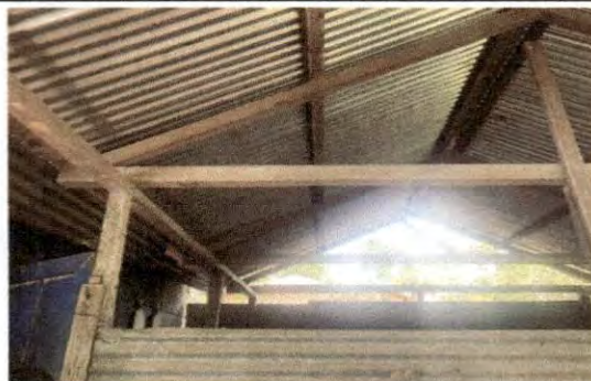
Foto 2: Estructura de madera y lamina en mal estado.
