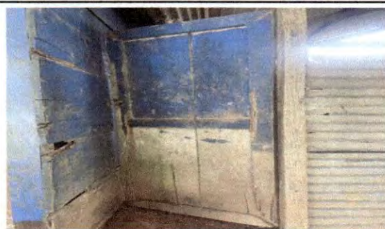
Foto 5: Puerta de cocina desgastada.
