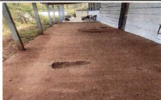
Foto 3: Piso de pasillo con hoyos.
