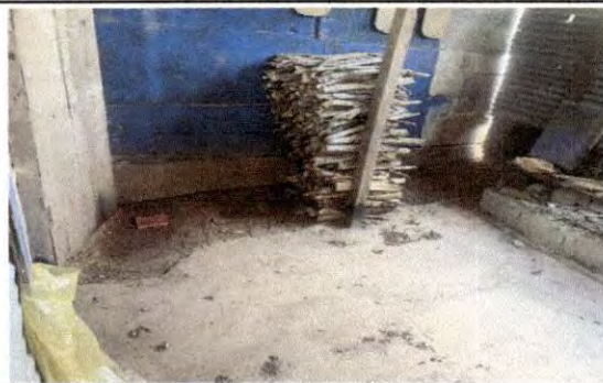
Foto 9: Cocina con piso quebrado.
