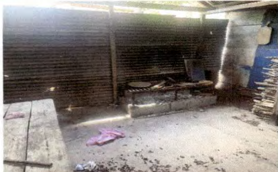
Foto 7: Cocina sin estructura adecuada en muros debido a que son en laminas.
